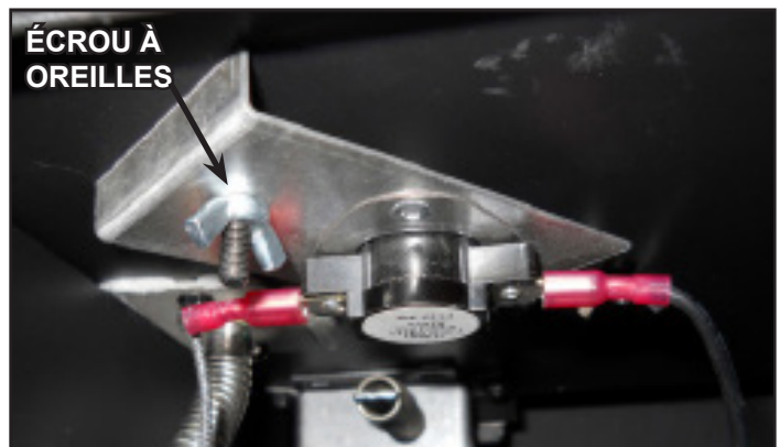
Figure 8.5 Interrupteur à capteur de température installé
